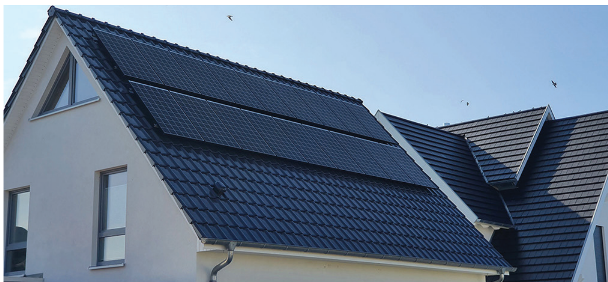
57 | Photovoltaikanlage auf einem Graal-Müritzer Dach
