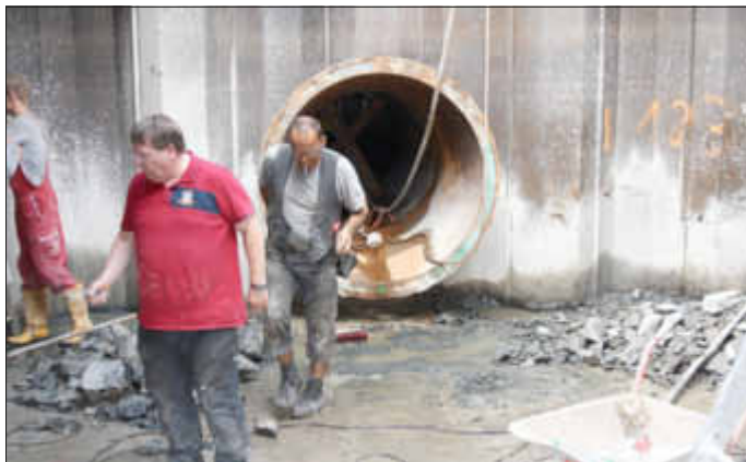
Das momentane Innenleben des Zwischenbehälters. An der Rückwand befindet sich der Anschluss der 280 m langen Auslaufleitung in die Ostsee.
