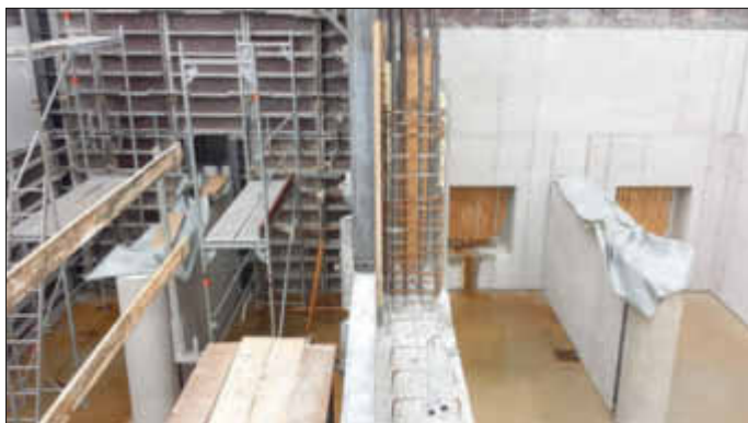
Die linke Kammer ist ausgeschalt. Deutlich zu erkennen sind die Öffnungen für den Anschluss der Druckleitungen von Pumpe 3 und Pumpe 4 zum Hochbehälter.
