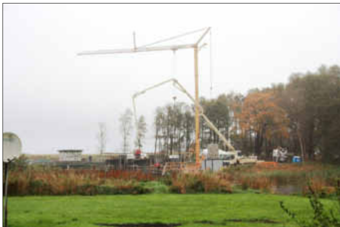
Die Größe der gesamten Baustelle ist erst aus einiger Entfernung zu erfassen.
