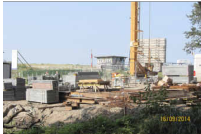
Viel verschiedenes Material und reichlich Gerätschaften auf dem Bauplatz der Firma TIAS.
