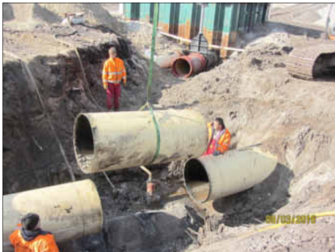
Ein Stück Druckrohr wurde herausgeschnitten. In diese Lücke wird die „Weiche“ eingefügt.
