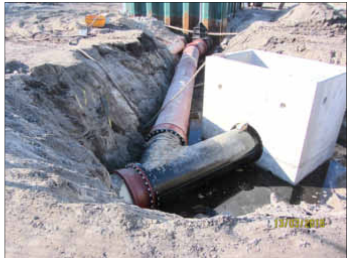
Die „Weiche“, linker Abzweig zum Zwischenbehälter, rechter zum Druckrohr. Weißer Kasten: Armaturenschacht
