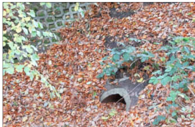
Mangelhafte Sohlenbereinigung Waldstraße West
