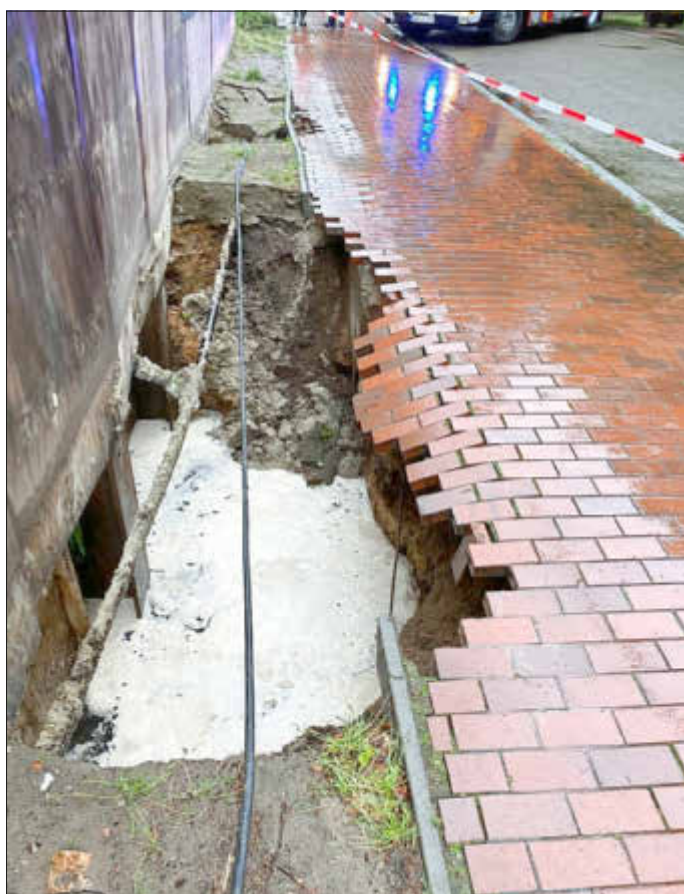
Unterspülter Weg am Hotelneubau in der Straße zur Seebrücke.
