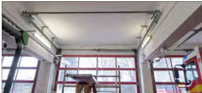
Selbst bei Tageslicht sieht man den Unterschied in der Lichtausbeute. Links ist die neue Lampe.
