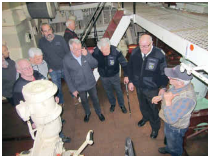
Im Maschinenraum der Generatoren.
