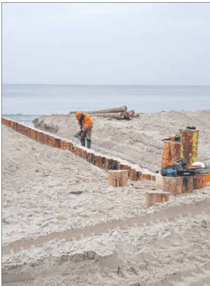
Sorgfältig werden die Pfähle auf gleiche Länge geschnitten und die Schnittkanten gebrochen.
