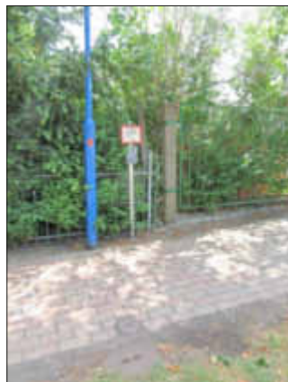
Unterflurhydrant in der Dr.-Leber-Str.
