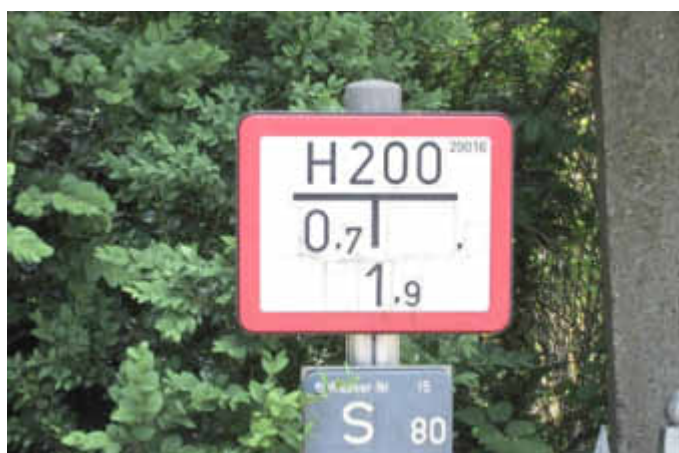
Das Hydrantenschild mit den wichtigen Angaben zur Wassermenge und zum Standort
