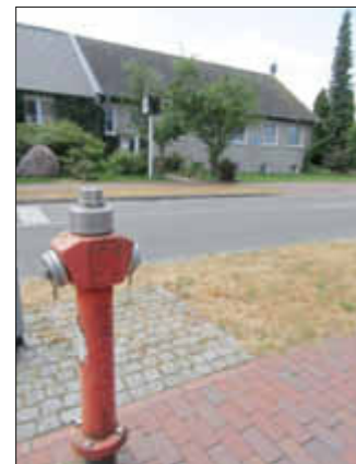
Überflurhydrant in der Langen Straße gegenüber der Feuerwehr.
