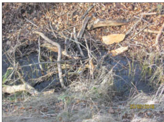
Zustand des Hauptentwässerungsgrabens im Graaler Wald
