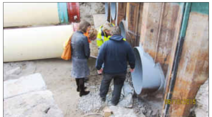
Herr Höpfner (Polier von TT) erläutert die noch anstehenden, zeitaufwändigen Arbeiten am Zwischenbehälter.
