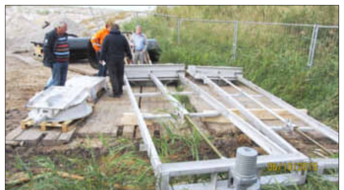
Die beiden Schieber mit E-Antrieb (rechts) und die beiden Klappen müssen noch in den Behälter eingebaut werden.
